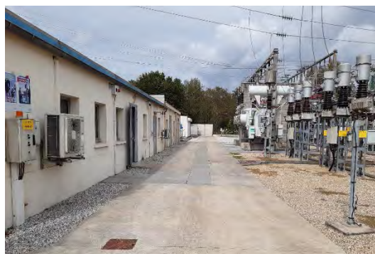
Entrée du poste (jeu de barres à droite, locaux technique à gauche) – source : ENEDIS
