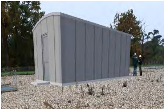
Photo type de salle HTA abritant une 1/2 rame HTA
