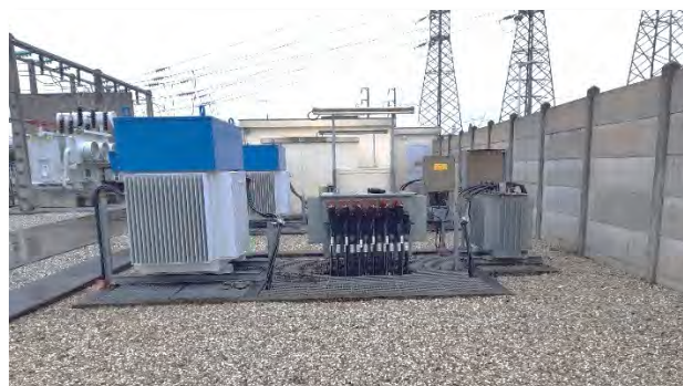
Grilles HTA liées aux transformateurs – source : ENEDIS
