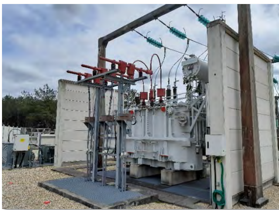
Photo type de transformateur – source : Apave
