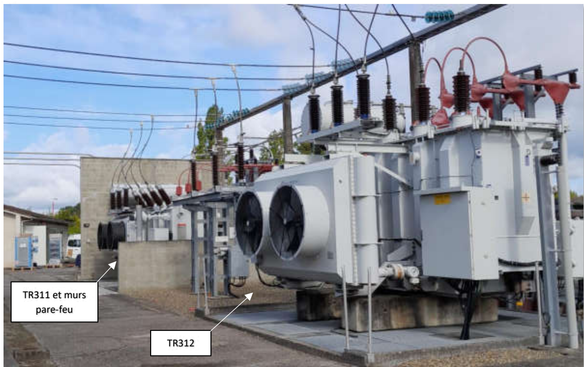
Transformateurs TR311 et TR312
