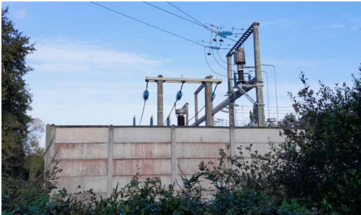
5 - Vue sur le poste de Parentis depuis le sud-est
