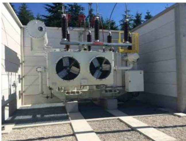
Illustration 7 : Exemple de transformateur (Source : ENEDIS)
