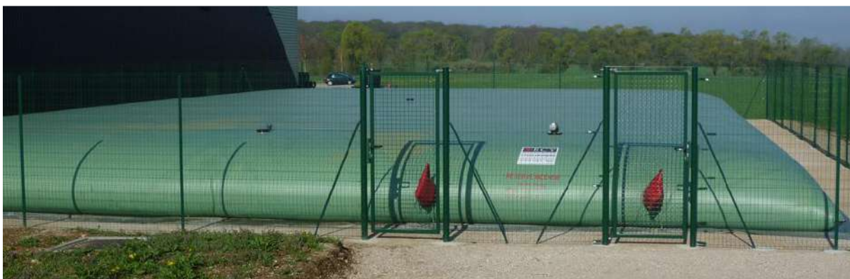
Exemple de citerne souple pour la lutte incendie
